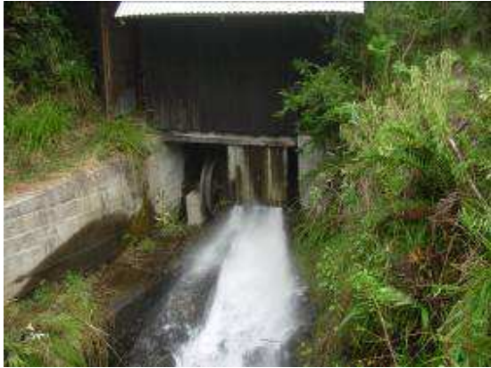
Foto 4.14. Caseta con generador y turbina.
